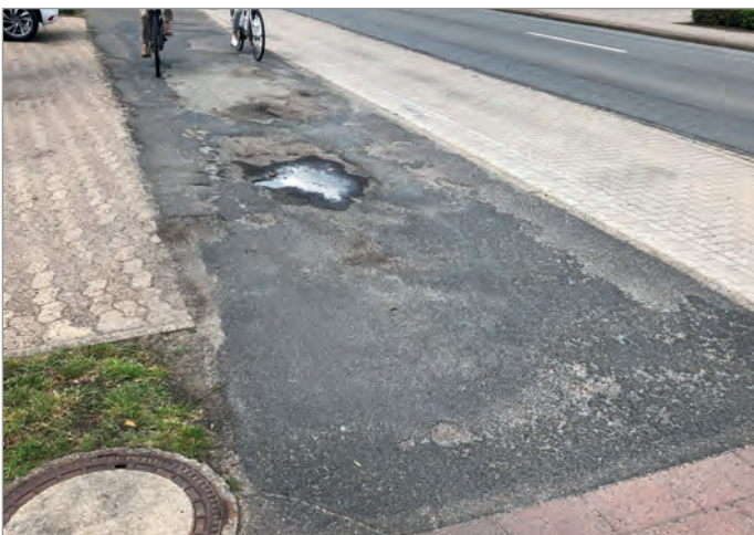
Abbildung 8: Schlaglöcher auf dem gemeinsamen Geh- und Radweg
