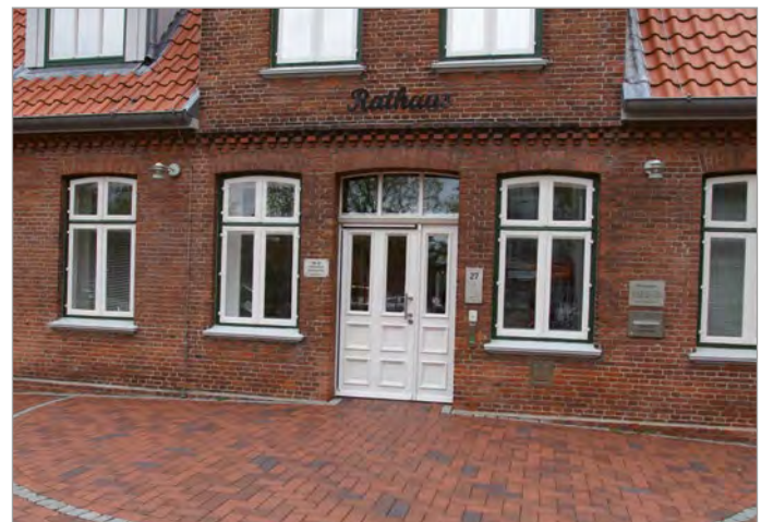
Abbildung 40: Automatische Türöffnung Rathaus Drochtersen
